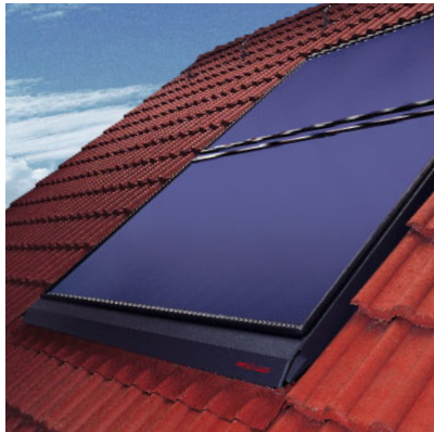
Kolektory zamontowane w dachu
