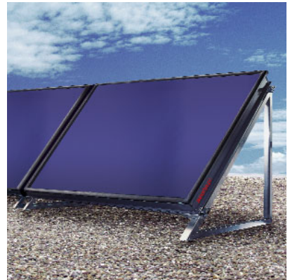
Kolektory zamontowane na dachu płaskim
