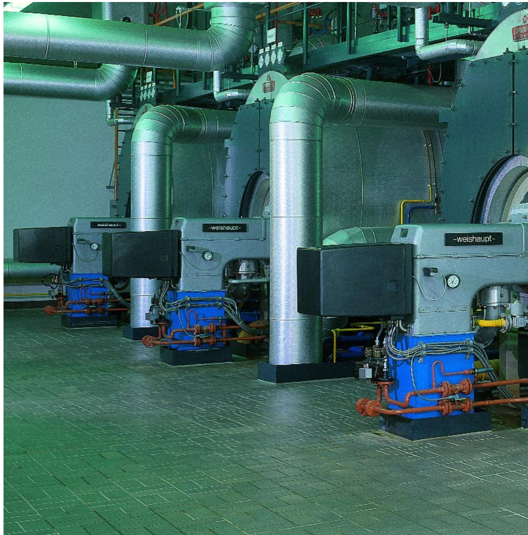
Ciepłownia miejska z dwupaliwowymi palnikami Weishaupt WKGL50 i WKGL3 - o łącznej mocy 28 MW
