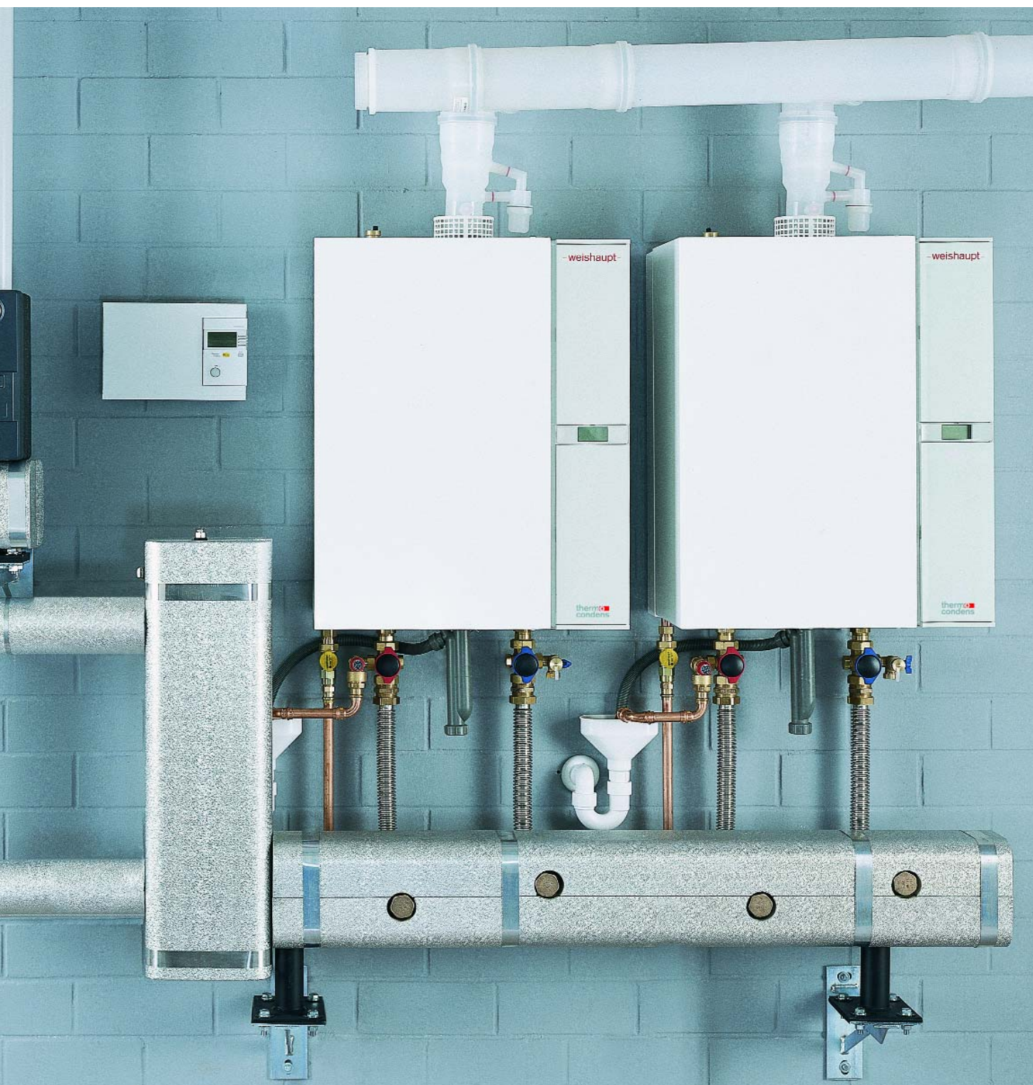
W kaskadzie kotłów Thermo Condens o mocy 240 kW minimalna moc modulacyjna rozpoczyna się od 5%, a następnie jest zwiększana bezstopniowo w zależności od potrzeb do mocy całkowitej.
